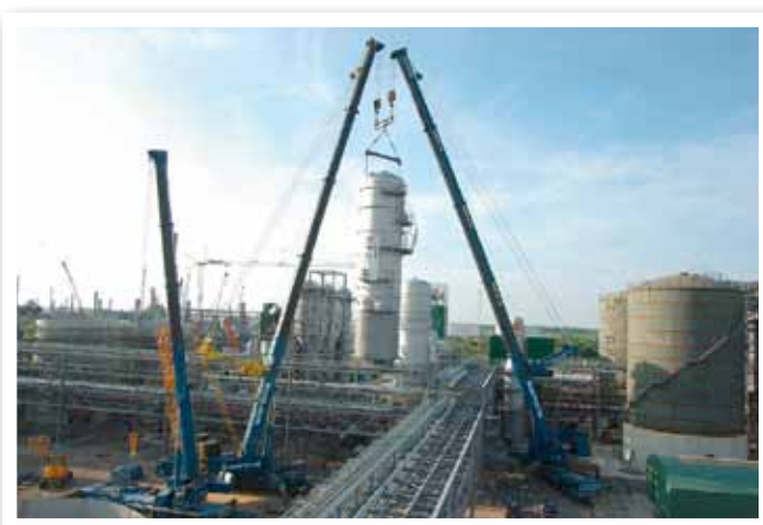
Einheben einer Kolonne unter erschwerten Bedingungen. Sarens Niederlande setzt hierfür den AC 700 Demag AC 500-2, Liebherr LTM1250/1 sowie eine Spezialtraverse ein und erhielt hierfür den Esta Award in der Kategorie „Teleskopkran-Einsatz“.
