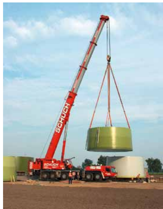
Um die ersten Turmschüsse der Enercon E82 zu montieren, wurde der 80 m Ausleger des GMK6300L auf 31,5 m austeleskopiert. Der Kran kam mit seinem maximalen Gegenge-wicht von 92,5 t zum Einsatz.
