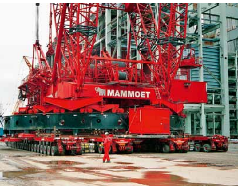
Falls nötig, kann der PTC auf Selbstfahrern oder auf Schienen verfahren werden.
