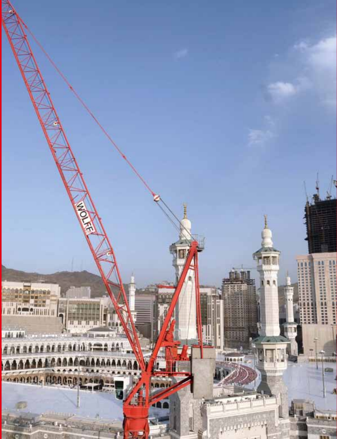
Für die Vergrößerung des heiligen Platzes von Mekka im westlichen Saudi-Arabien wurden 44 Wolff-Krane erworben. In einer ersten Bauphase wurden 20 Wipprane montiert.
