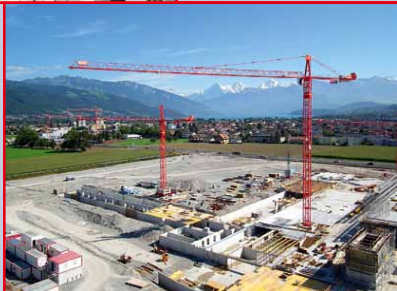
Wolffkrane im Einsatz im schweizerischen Thun. Vor allem die Schweiz zählte für Wolffkran zu jenen Märkten, die während der gesamten Krise konstant stabil waren.
