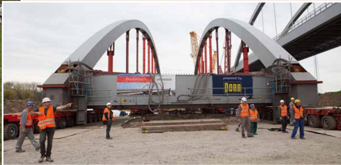
▲ Auf zwei Selbstfahrern wurde die Brücke zunächst auf die Baustelle an das Störufer gefahren. ▼
