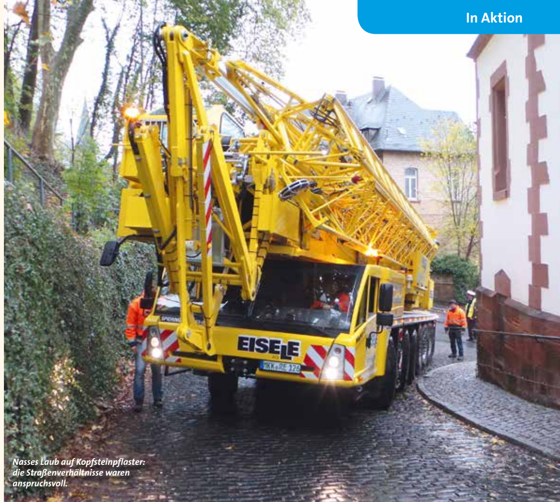
Bei dem Einsatz musste der Spierings SK1265-AT6 möglichst nah am Objekt aufgestellt werden.
