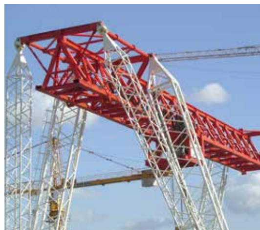
Vor der ersten Inbetriebnahme und nach wesentlichen Änderungen von Kranen müssen Prüfungen stattfinden, die von Kransachverständigen durchgeführt werden.
