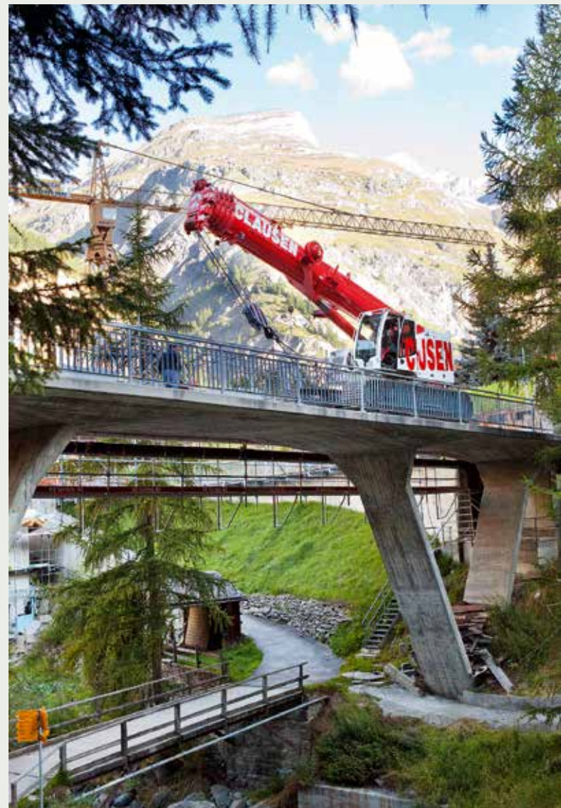
Vom Tieflader genommen passiert der Raupenkran diese Brücke im Alleingang. Die Tragfähigkeit der Brücke war für den beladenen Transporter zu gering.
