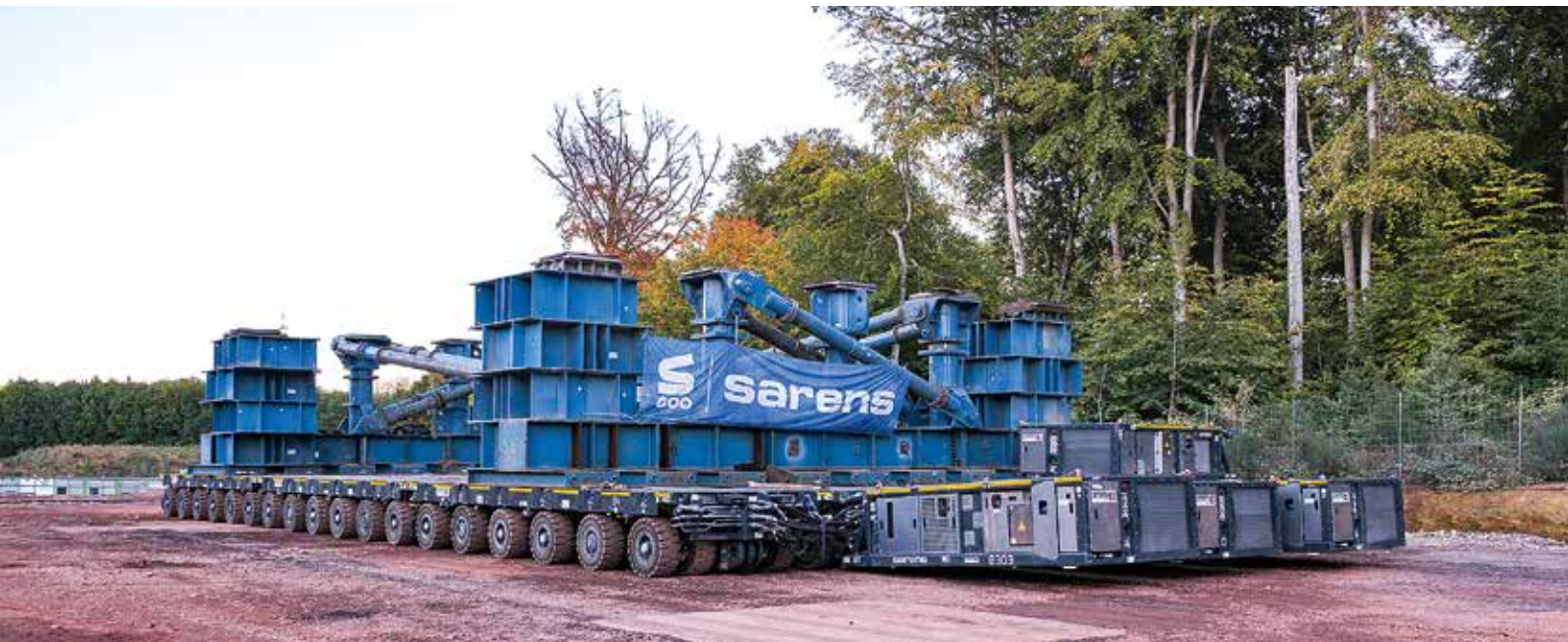
An jedem Ende der Brücke wurde diese 5x18 Achslinien Kombination für den Vershub positioniert.
