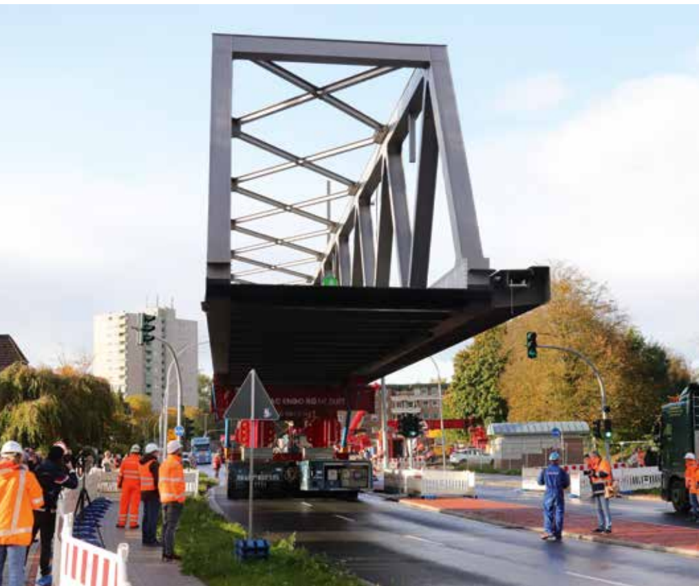
Notwendige Straßensperre: hier bleibt kein Platz für weitere Fahrzeuge.
