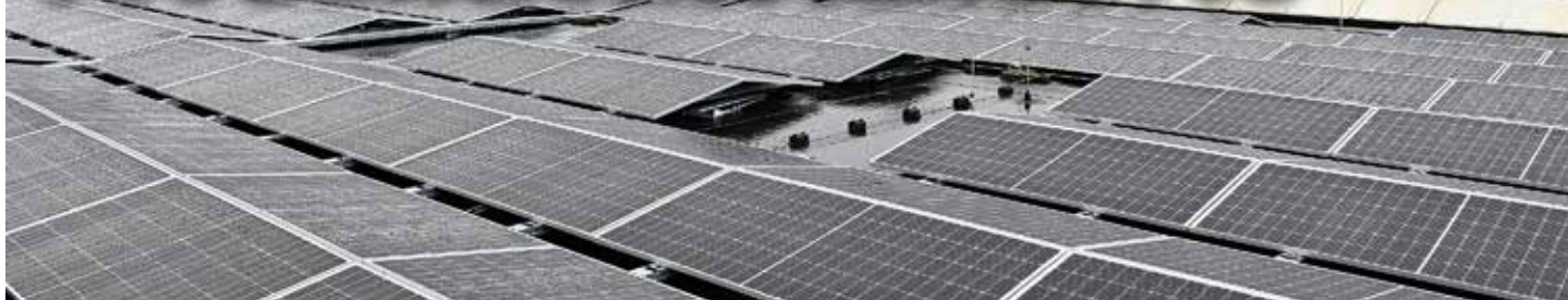
Im Werk Kassel versorgt eine 4.000 m 2 große Photovoltaikanlage die Produktion mit Strom.
