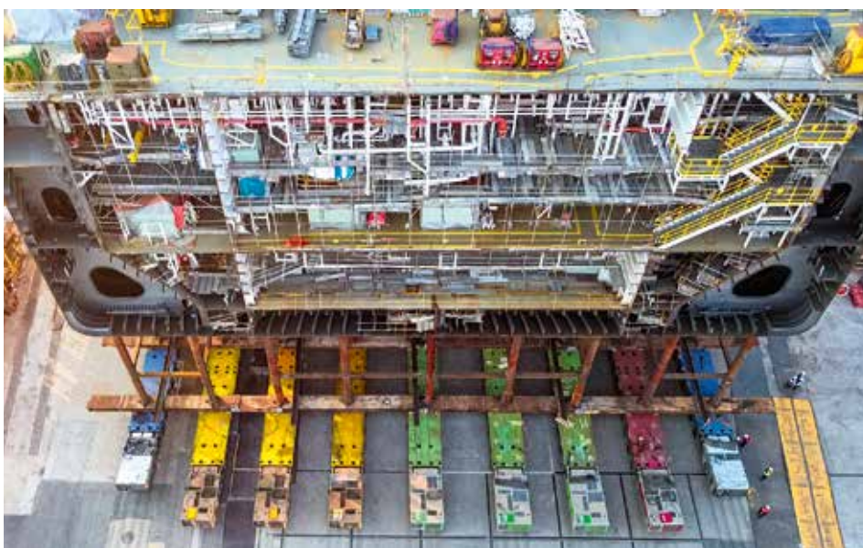
Bis zu 360 Achslinien Cometto SPMT wurden bei den Transporten der Blöcke kombiniert.
