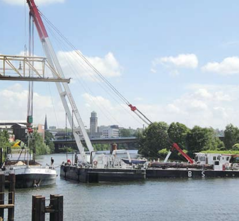
Umschlag in Osnabrück: Zwei Teleskopkranne mit einer maximalen Tragkraft von 500 t kamen im Hafen von Osnabrück zum Einsatz. Bild: schwerlast-nrw.de
