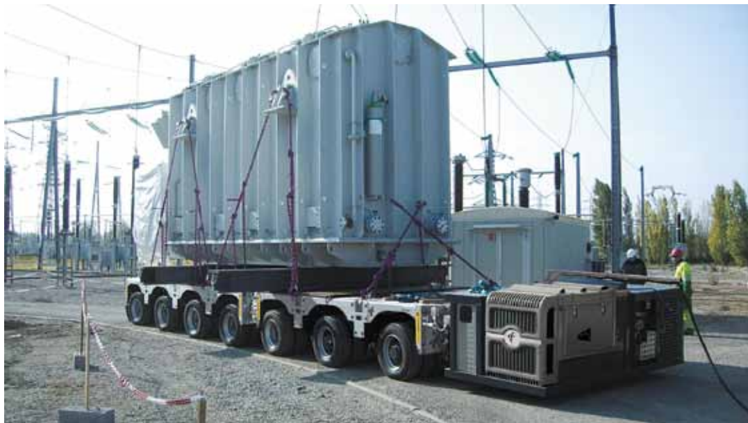
Bei innerbetrieblichen Anwendungen, wie beim anschließenden Einbringen des Trafos in das Umspannwerk in Narbonne, wird der Powermax bei Geschwindigkeiten von 5 bis 6 km/h als Selbstfahrer verwendet, und benötigt somit keine externe Zugkraft.
