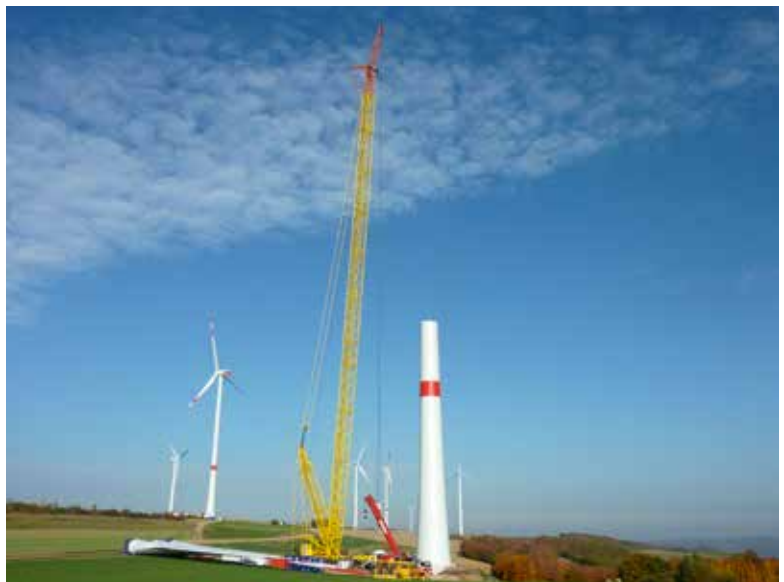
RePower-Projekt in Rheinland-Pfalz.
