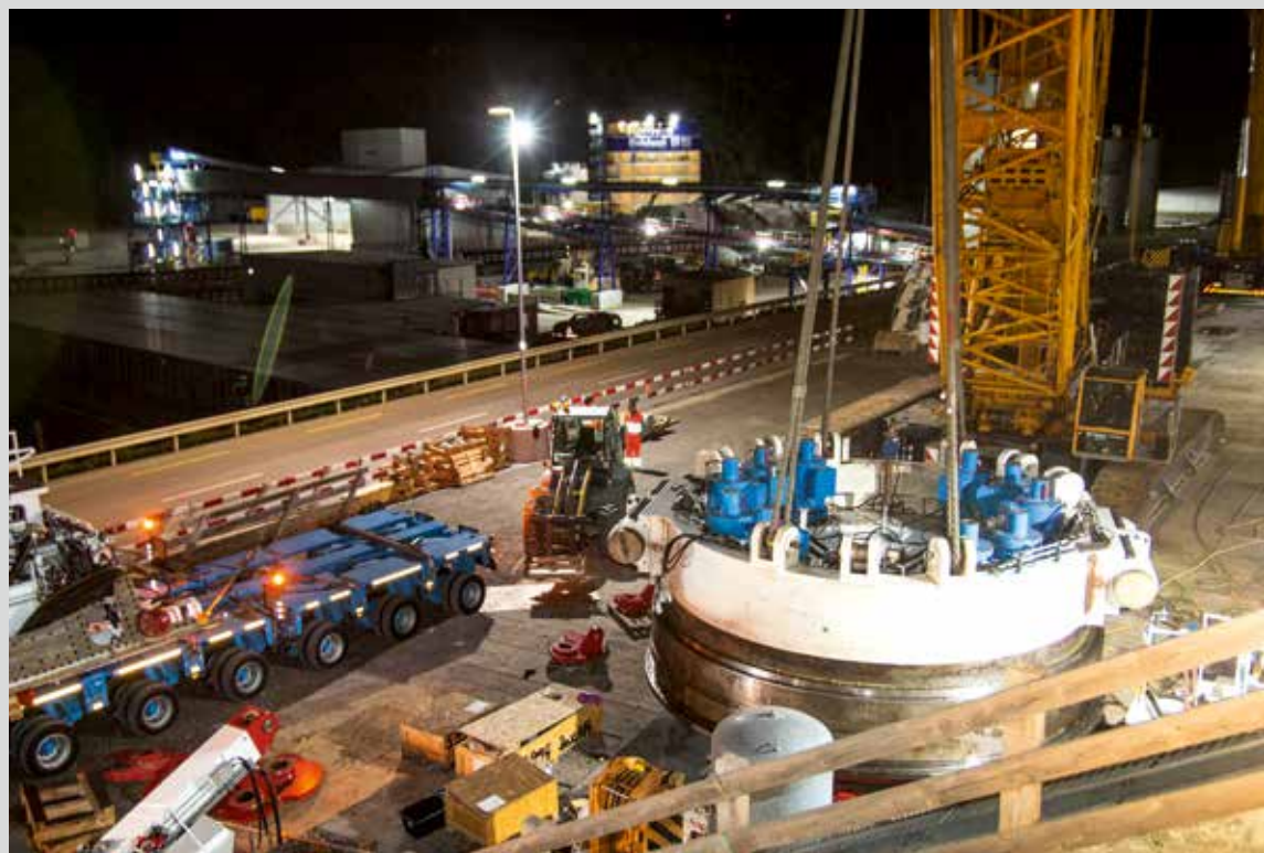
An der Baustelle steht schon der Demag CC 2400-1 von Toggenburger bereit. Einerseits, um die angelieferten Komponenten zu entladen, hier das eintreffende Schildsegment, andererseits, um die später weiter zusammenggebauten Komponenten in die Baugrube abzusenken.
