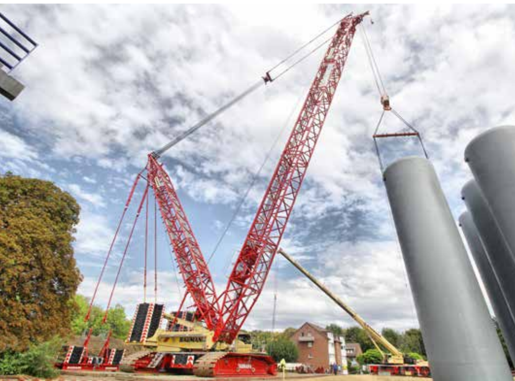
Mit dem Superlift 3800 von Baumann wurden die Behälter in Hürth aufgerichtet und montiert.
