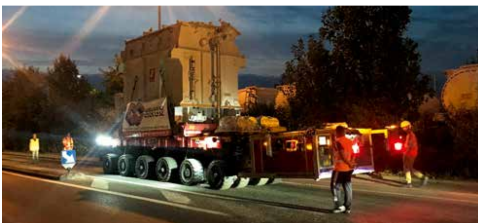
Ein sehr kompakter Schwertransport ist auf seinem Weg zum Umspannwerk in Gennevilliers.
