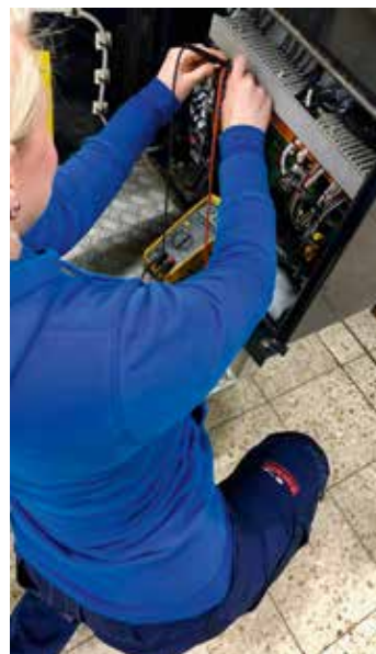
Durchmessen einer Can-Bus-Steuerung.
