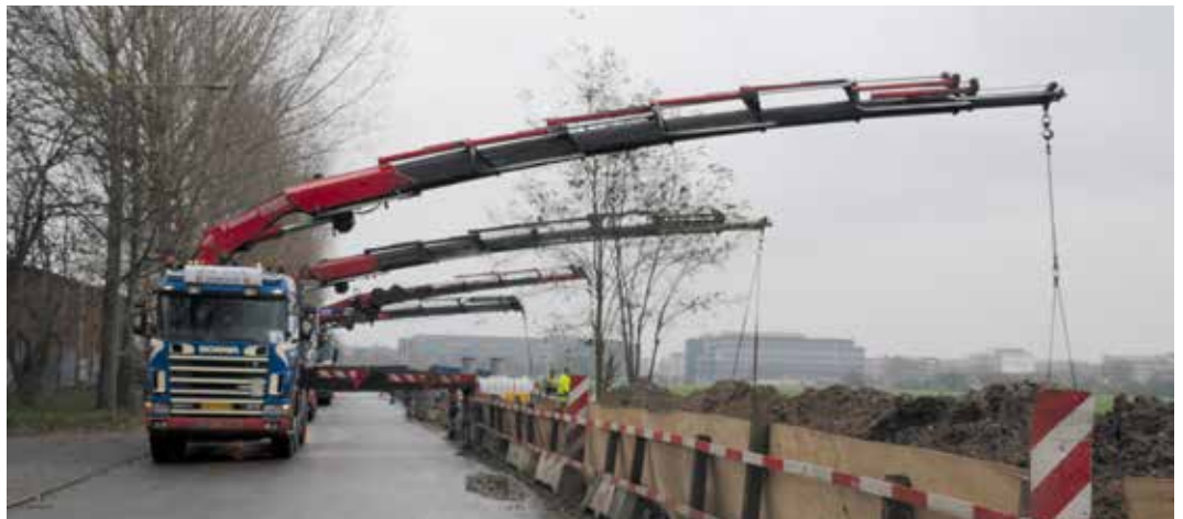
Vier Groß-Ladekrane beim Einheben von zwei Fernwärmerohren mit einem Durchmesser von 1,20 m Durchmesser im Zentrum von Kopenhagen.
