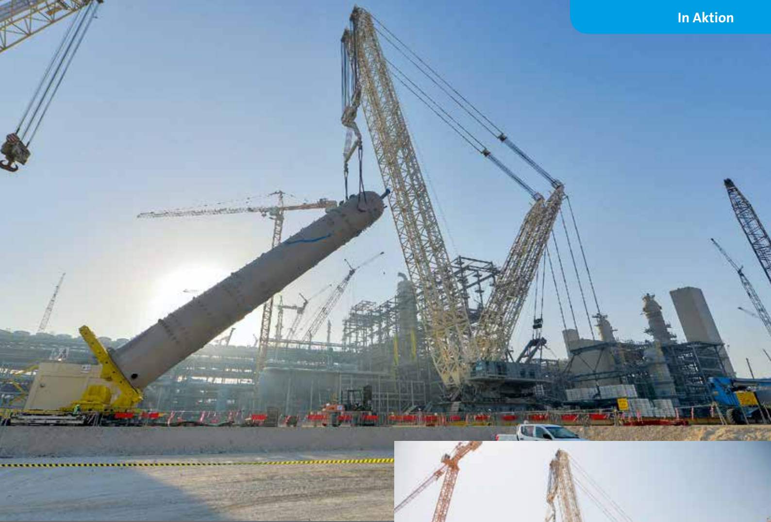
Nachdem die SPMTs unter weggefahren wurden, konnte der Absorber in die Vertikale gebracht werden.
