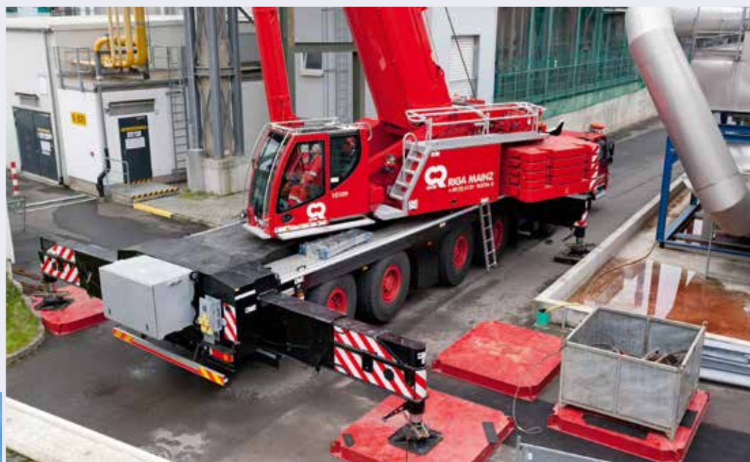
Bei diesem Einsatz von Riga Mainz war das VarioBase-System des neuen 300-Tonnners ein großer Vorteil.
