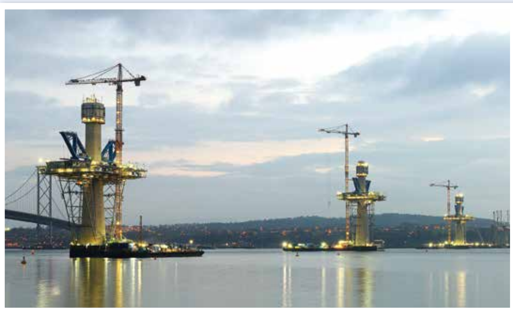
Die drei Krane sind mit 36 m langen Auslegern ausgestattet und heben an der Auslegerspitze bis zu 18 t. Bis zu einer Ausladung von 18 m sind die Krane auf 40 t Traglast ausgelegt.
