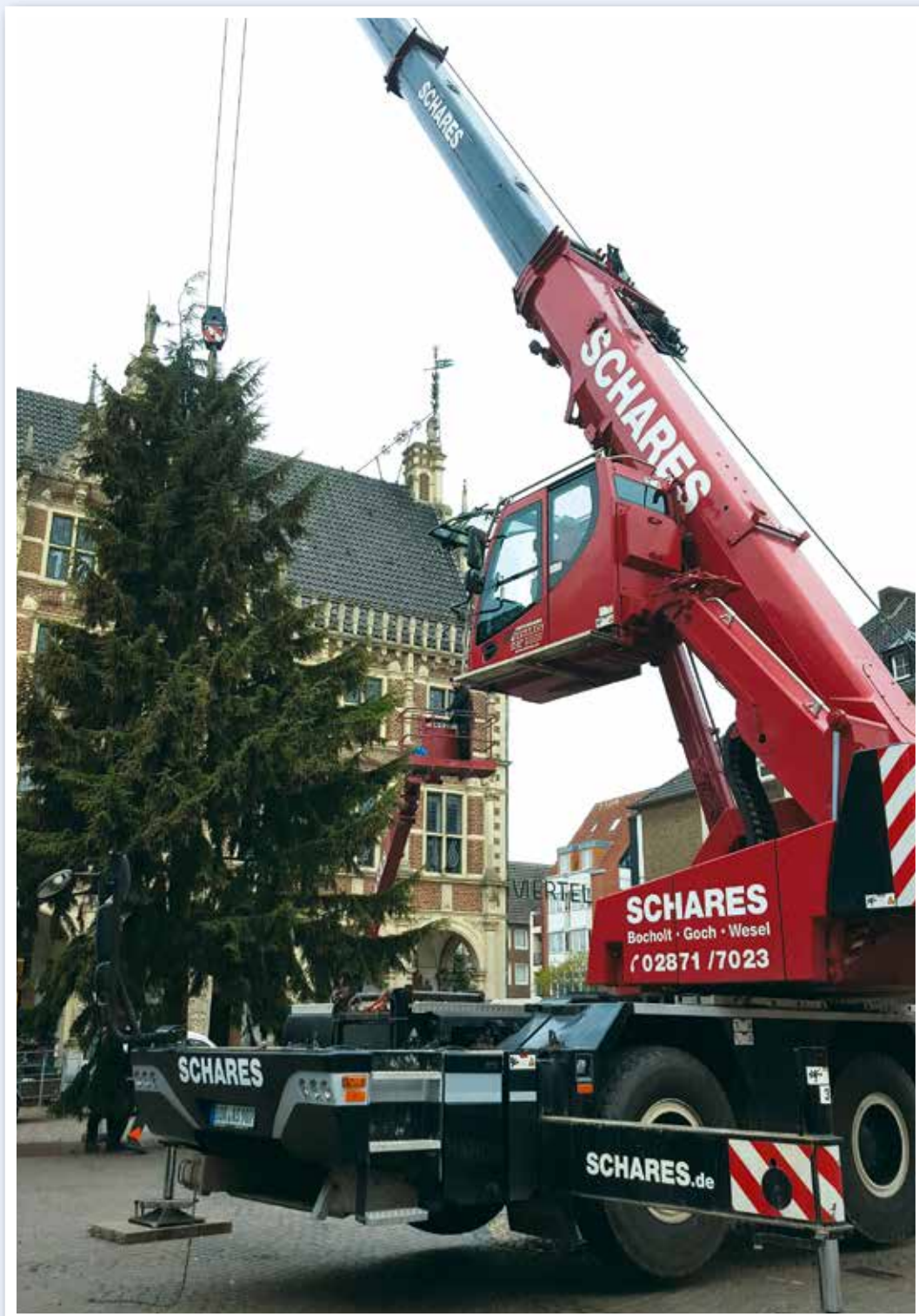
Vor dem Historischen Rathaus in Bocholt setzt ein Liebherr LTC 1045-3.1 eine Tanne in die vorbereitete Bodenhülse.
