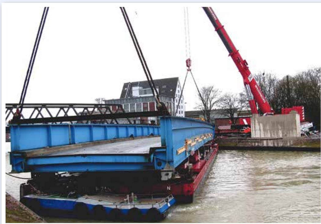
Auf dem Wagenborg Lastponton 3 reist die Brücke nach Münster, dort wird sie von einem Terex AC 700 und einem LTM 1750 auf die Fundamente gehoben.
