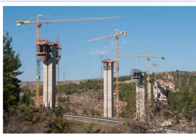
Die Potain-Turmdrehkrane MD 365 B, MDT 178 und MD 285 im Einsatz an der größten Brücke Israels.
