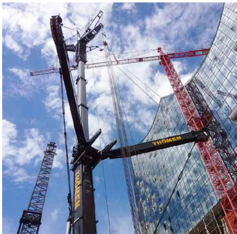
Am Haken: Der 60 m lange Katzausleger wurde in zwei Teilen demontiert. (Foto: Marc Bernschneider/Thömen)
