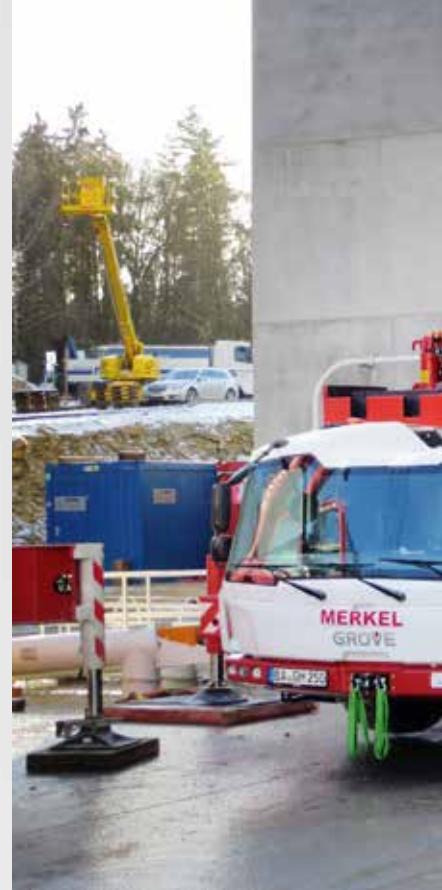
Der neue GMK5250L der Merkel Autokrane GmbH bewährte sich bei der Montage einer Silo-Anlage.
