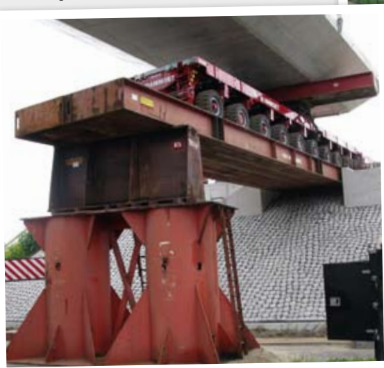
Damit der Selbstfahrer die Brücke so nah wie möglich an die Krane heranfahren kann, wurde eine Behelfsbrücke auf Elefantenfüßen positioniert.
