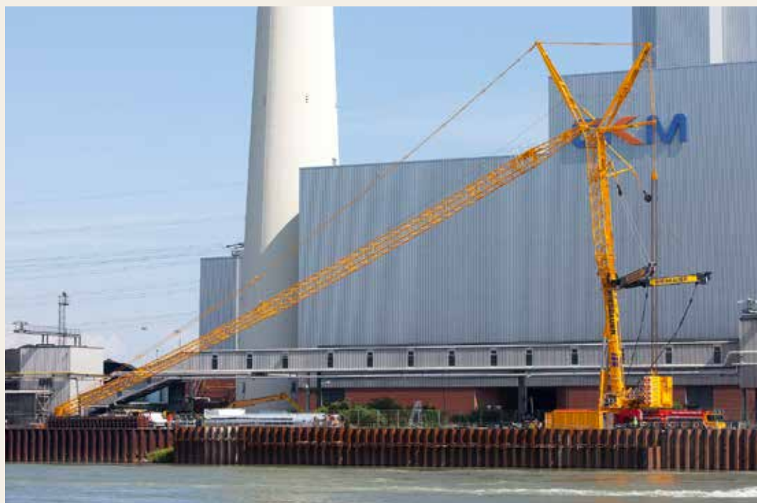
Sobald die drei Teleskope ausgefahren sind, wird die 91 m lange Gittermastspitze aufgewippt.
