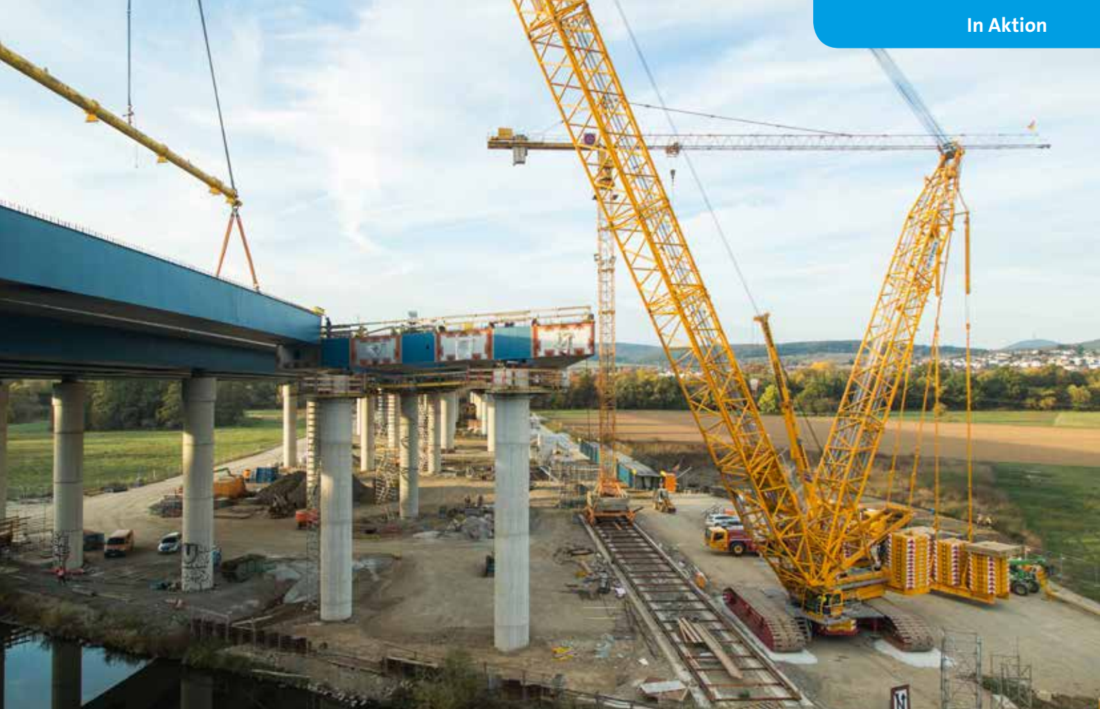
Der CC 3800-1 wurde direkt neben die Schienen platziert, auf denen ein Turmdrehkran von Baufeld zu Baufeld versetzt wird.
