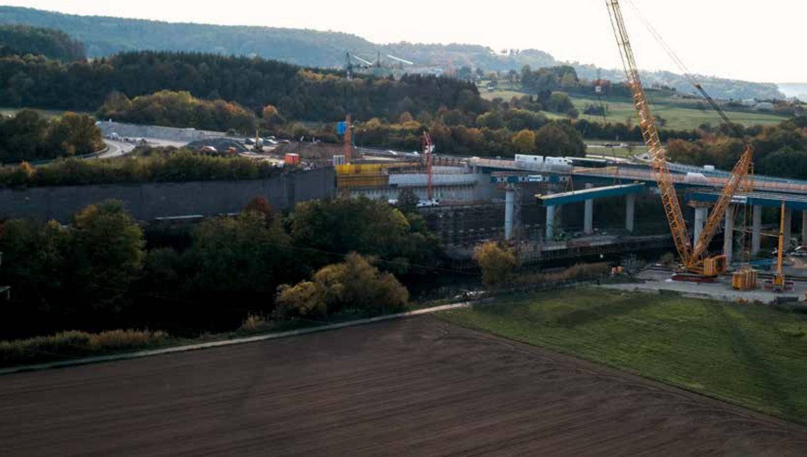
Auf insgesamt 490 m wurde die Lahntalbrücke an der A45 bei Dorlar ersetzt.
