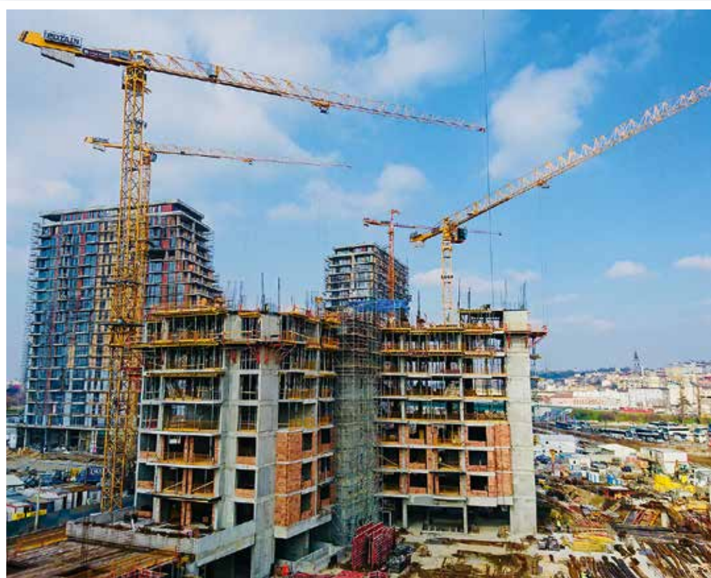
Bei dem Großprojekt „Belgrade Waterfront“ sind auch diverse Turmdrehkrane von Potain im Einsatz.
