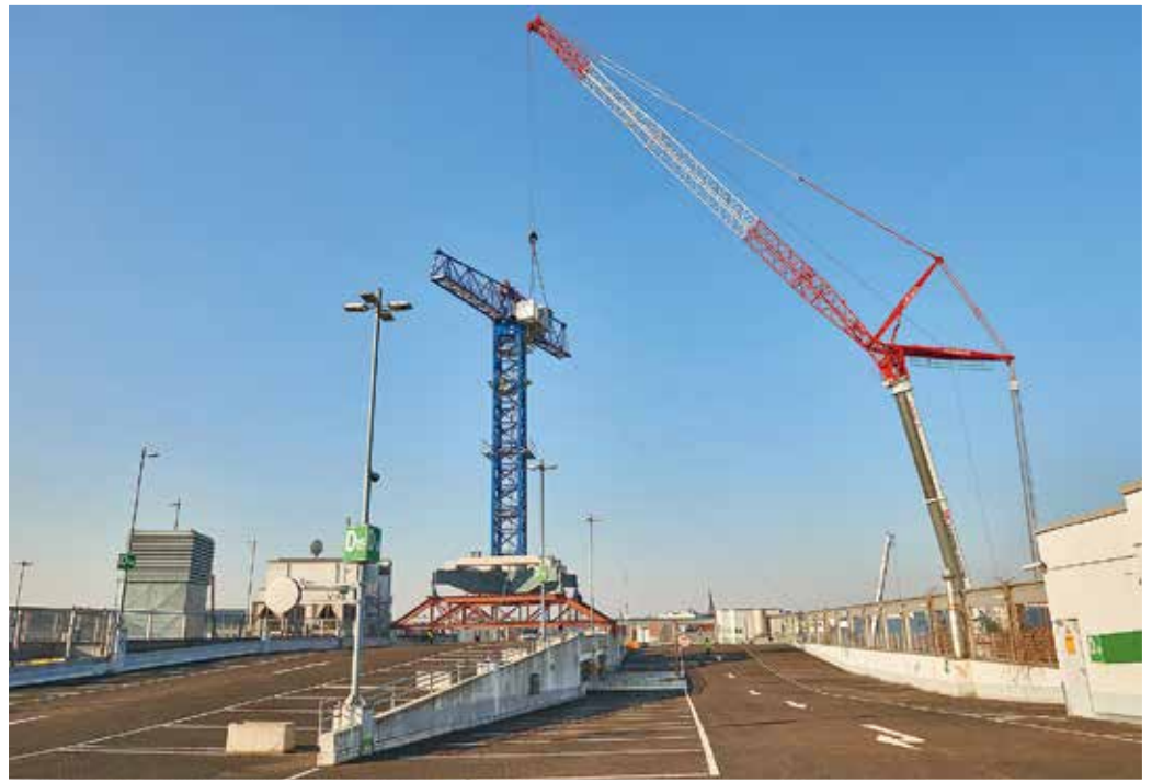
Für die Montage des Comansa 21 LC 750 setzt BKL einen LTM 1500-8.1 mit 49 m Wippe und 165 t Ballast ein, um die notwendige Ausladung von 50 m zu erreichen und den Obendreher auf eine Hakenhöhe von 20,4 m rund 20 m über dem Boden aufzubauen.
