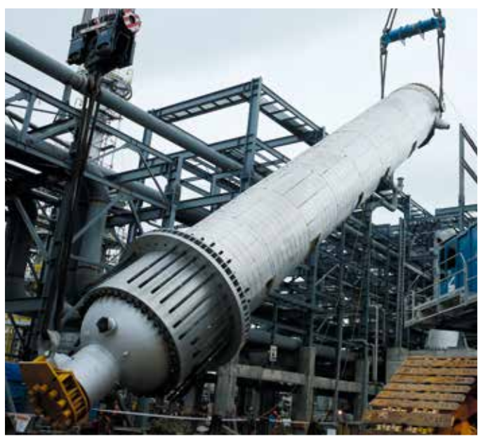
425 t schwer, 53 m lang und 3,8 m Durchmesser: diesen Harnstoffreaktor hebt der CC 8800-1 in Indien in Position.
