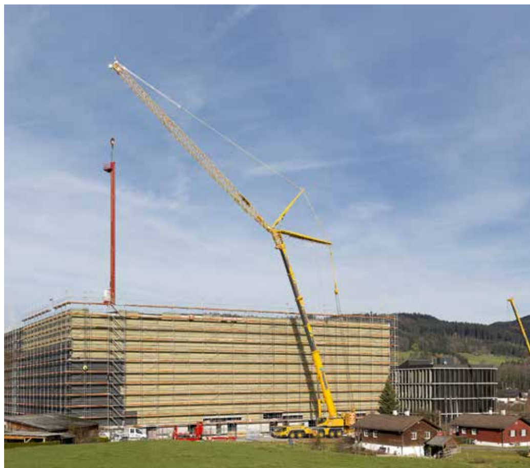
Große Reichweite: bei einer Ausladung von 42 m wird das Regalbediengerät durch das Dach des neuen Lagergebäudes abgelassen.
