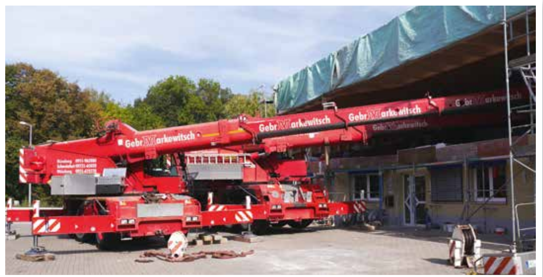
Dicht bei dicht: ein AC 70 City und ein AC 40 City montieren gemeinsam Stahlbetonträger.
