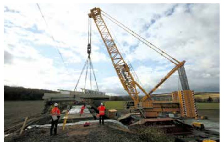
Es folgt ein 180°-Schwenk nach links, und die Tragplatte gelangt zur Brücke – hier wird sie in Position gezogen.
