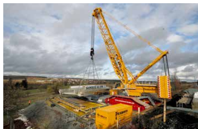
Zuvor wird das Betonfertigteile aus der Schalung gehoben und zunächst nach rechts geschwenkt, um die Tragplatte für den Einhub weiter vorzubereiten.
