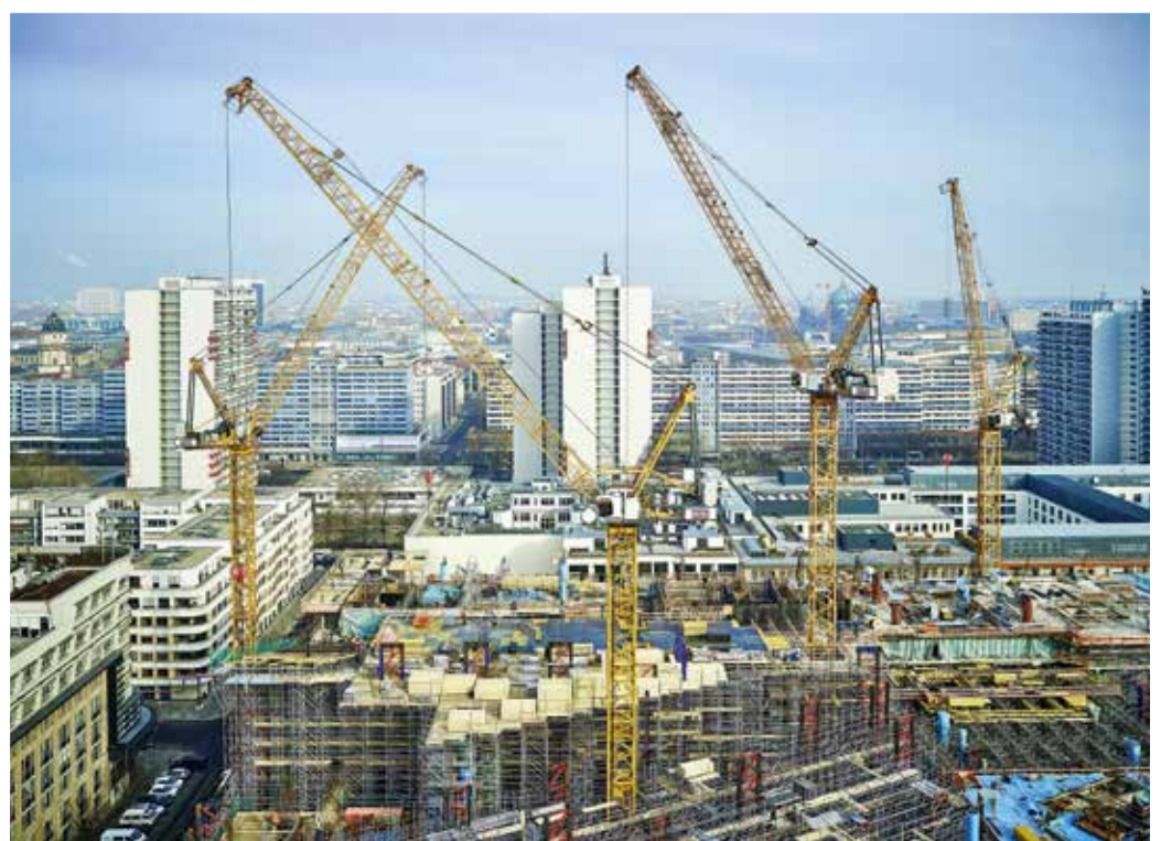
Sechs Verstellauslegerkrane von Liebherr kommen beim Bau des Axel-Springer-Neubaus in Berlin zum Einsatz.
