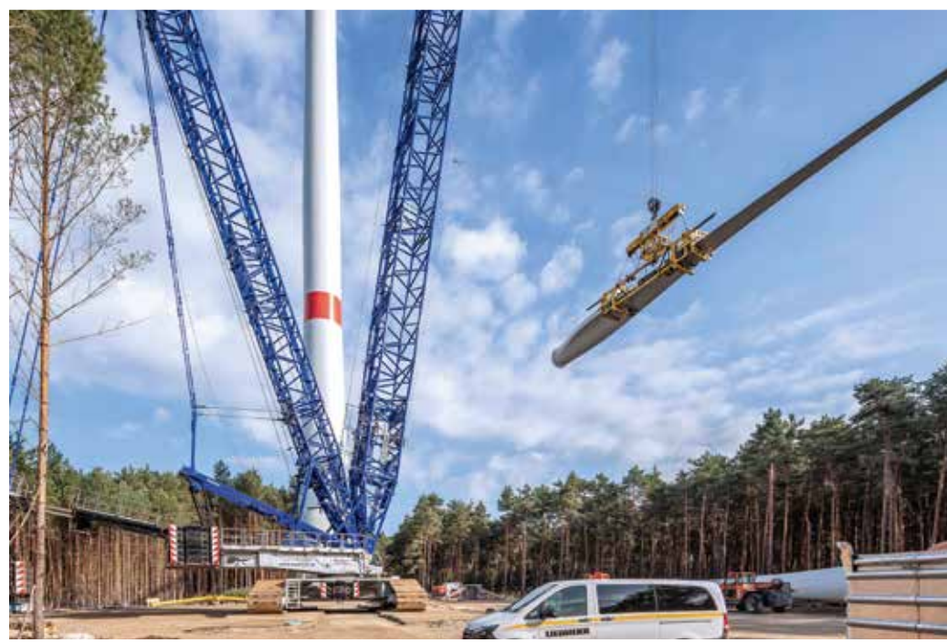
Optimale Winkel: Die horizontale Krafteinleitung auf die Flügel vom Hauptausleger aus verbessert die Laststeuerung bei der Flügelmontage deutlich.
