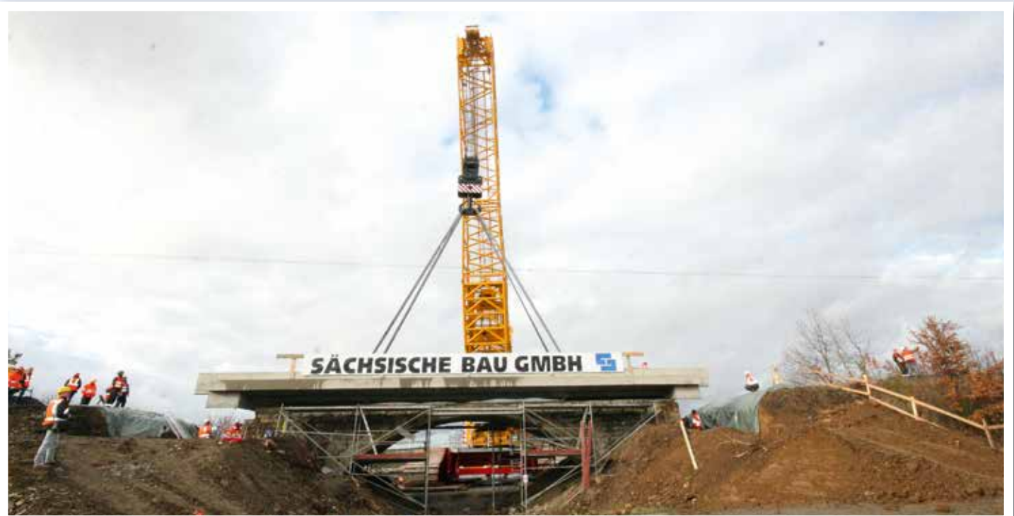
Fast geschafft! Die Tragplatte schwebt in der richtigen Position über dem Brückengewölbe und kann abgelassen werden.
