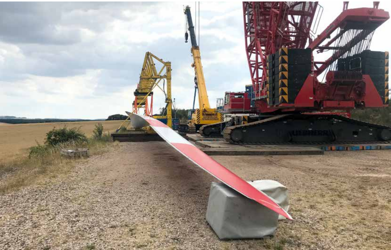
Beim Austausch einer Nabe werden die Rotorblätter zwischengelagert. Zum Einsatz kamen dabei ein LR 1600/2 sowie ein LTR 1100 als Hilfskran. KM-Bild
