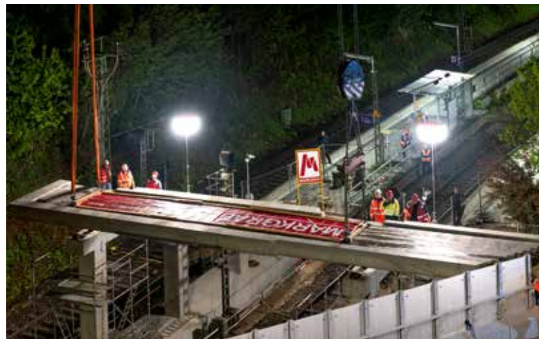
Am Ziel: Das Stahlbeton-Element wird in einer Distanz von 30 m über der gesperrten Zugtrasse auf seine Pfeiler gesetzt.
