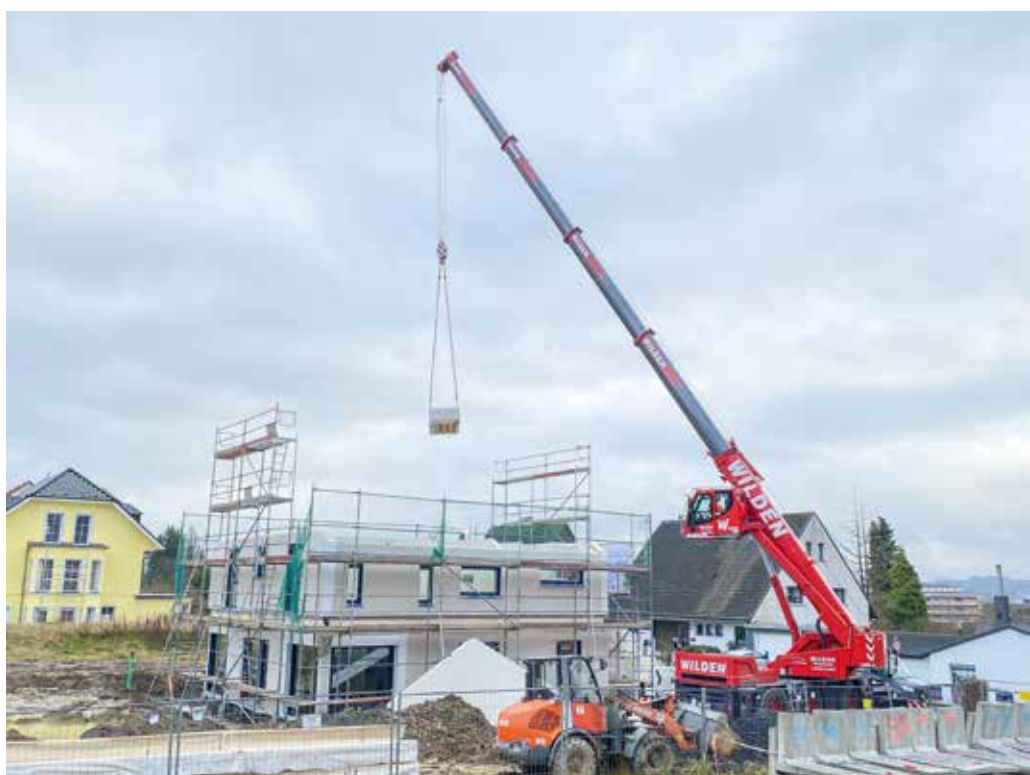
Gut erkennbar die hochfahrbare Krankabine.
