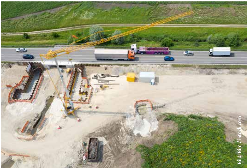
Bundesweit müssen inzwischen 13.000 Brücken saniert werden, 4.000 davon dringend.
