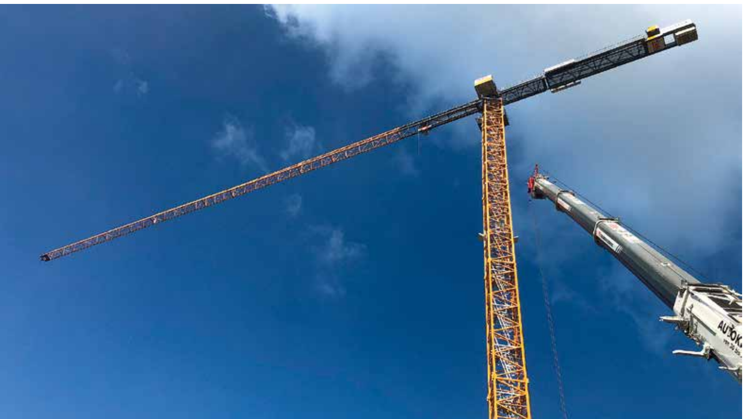
Durch seine besondere Konfiguration erreichte der LTM 1450-8.1 von BKL nicht nur die erforderliche Hakenhöhe von 90 Metern, sondern konnte die Auslegerteile mit jeweils rund 16 Tonnen Gewicht heben, ohne umzusetzen.
